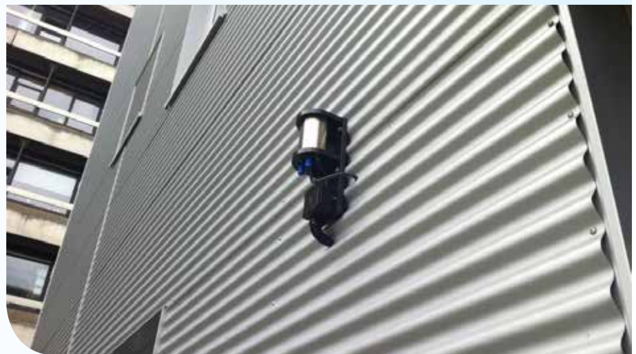
Anwendungsbeispiel: Referenznullpunkt montiert an Gebäudeaußenwand
